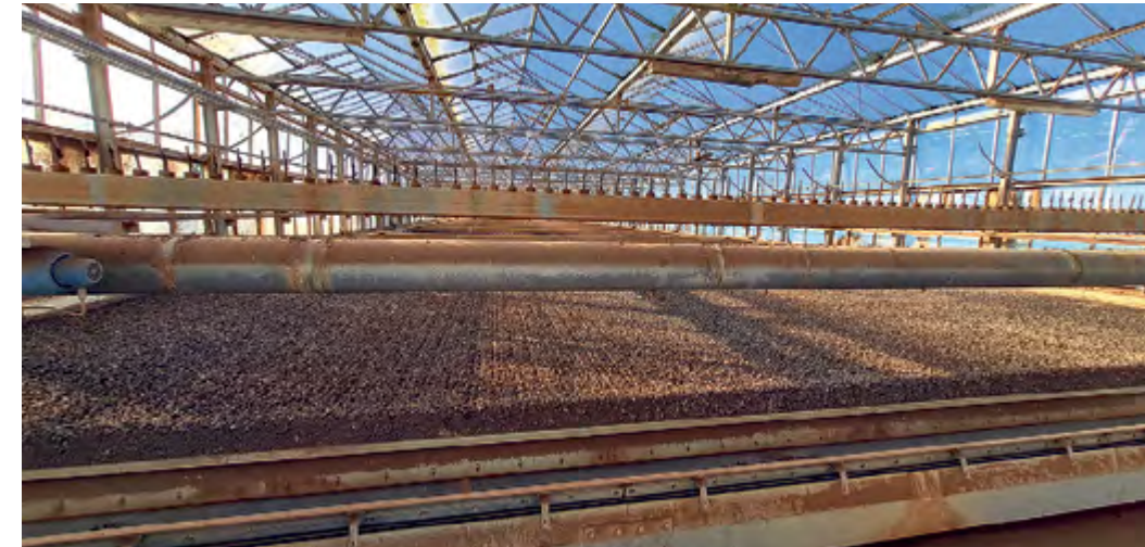
In der Trocknungsanlage wird der Schlamm zu Pellets verarbeitet, die dann im Frühjahr als Dünger auf dem Acker landen.
